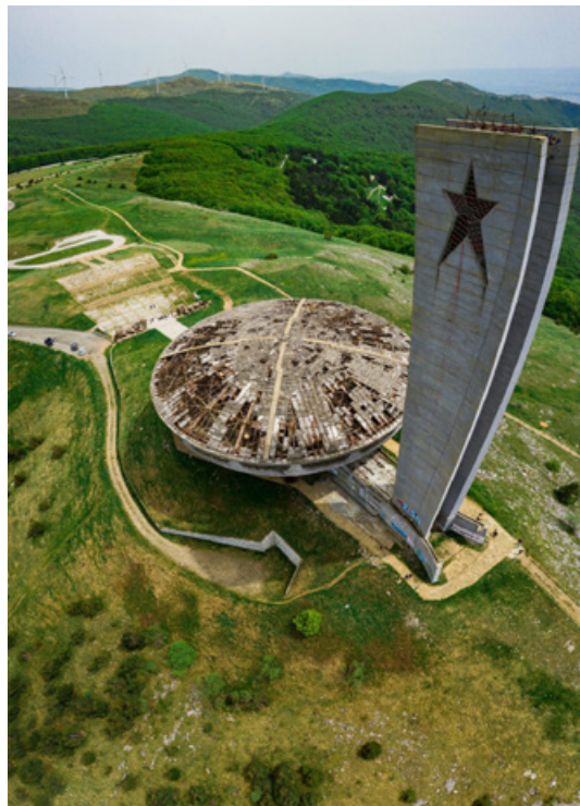
Fig. 6. Vue aérienne du monument aujourd'hui, révélant les nombreuses lacunes sur le toit, permettant l'infiltration d'eau, de grêle ou de neige en son sein (Jivko Iordanov, 14/07/2020, sur le site Wildlife Archive , photographie téléchargée le 28/04/2022, URL : www.wildlifearchives.com )
