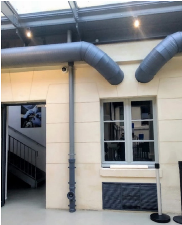
Fig. 4. Photographie qui montre deux gaines de ventilation et une descente d'eau pluviale, prise au rez-de-chaussée du pavillon Ouest dans la zone de desserte (janvier 2021, © Anaïs Ferreira).
