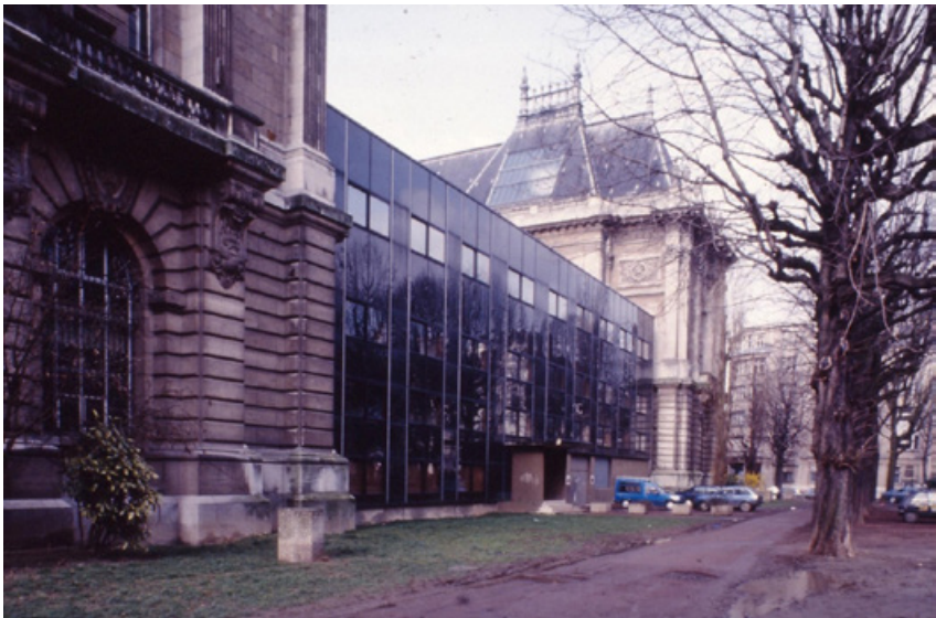
Fig. 2. Construction de l'extension administrative côté jardin, accolée à l'atrium, en 1978, plus tard surnommée la « verrue ». Archives du Palais des Beaux-Arts.
